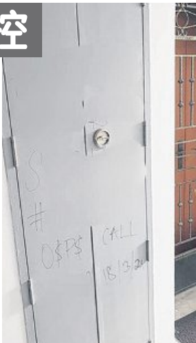
▲单位旁的电箱门被涂漆。(警方提供)
